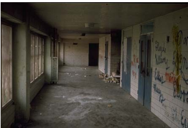
Foto 5: zeigt einen Korridor im Endstadium, als der Großteil der Wohnungen bereits leer stand.
